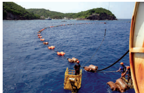
▲ Компания «Нексанс» поставит подводный силовой кабель, который соединит о-в Хайнань с континентальным Китаем
