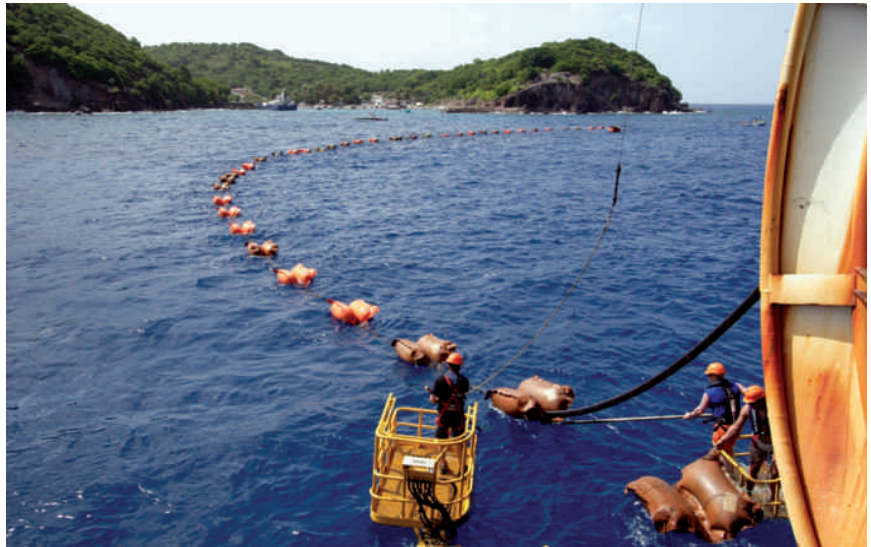
▲ Nexans wird eine Untersee-Starkstromverbindung zwischen der Insel Hainan und dem chinesischen Festland errichten
