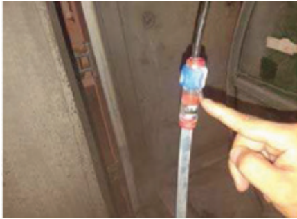
▲ Figure 5: Eau gelée autour des bouchons d'extrémité
