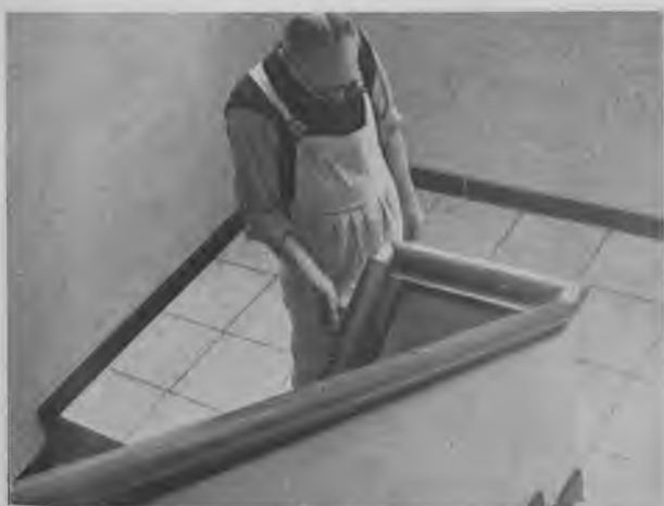
Fig. 1312. Trappegelænder fra Arbejdsmands Forbundets hus i København. Det er ikke til alle trappegelændere, der hører balustre, men vangen mod durchsigten kan være muret eller støbt op, så håndlisten fastgøres oven på det støbte. Her er »svingene«, som det ses på billedet, ikke runde, men lige og samlet med skarpe gehringer.
