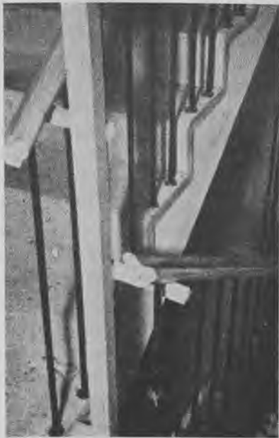
Fig. 1301. Gelændersnedkeren må afstive balustraden fra kælder til kvist med lægter. Her er håndlisten på de lige løb skåret til og klar til at få svingene fastlimet.
