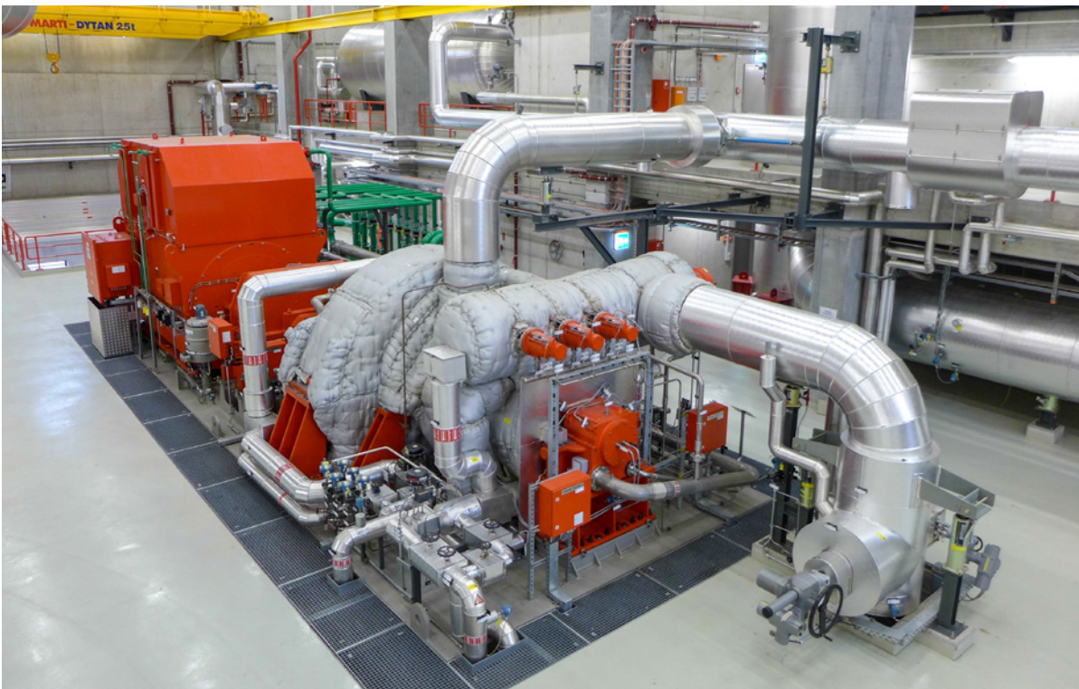
«Turbogruppe» in der Kehrrechtverbrennungsanlage Perlen/Root (Quelle Foto: Renergia Zentralschweiz AG)
