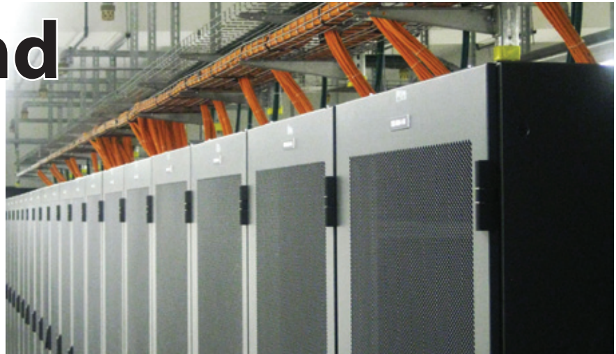
▲ Das neue Rechenzentrum von Dätwyler
