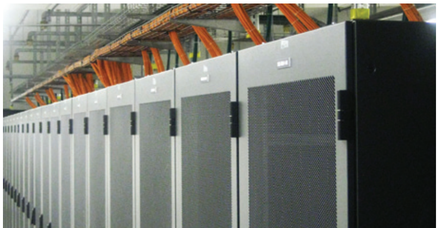
▲ Nuevo centro de datos cableado por Datwyler
