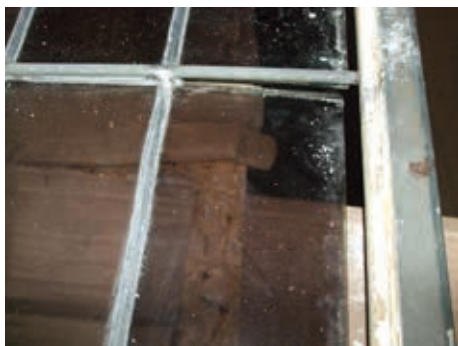
MANGE AV VINDUENE var i svært dårlig forfatning.
