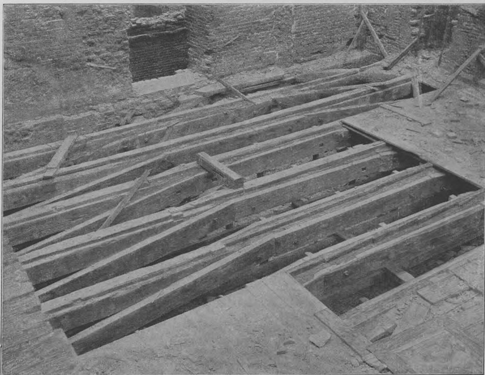
Sprængværk under Drabantsalen. Fot.
