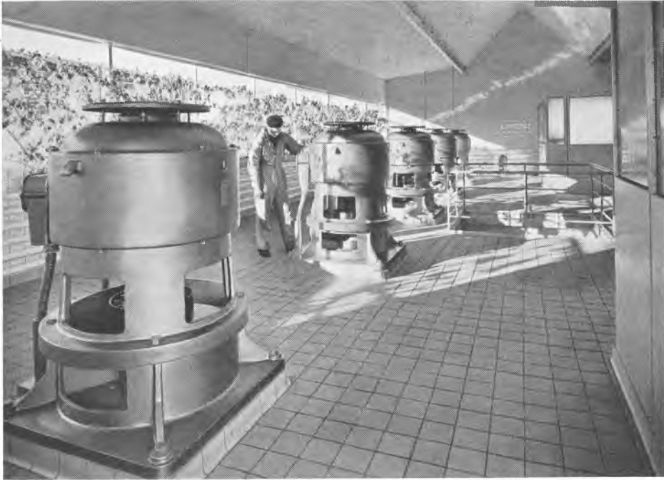
Interiør fra Pumpestation i Skovshoved med vertikale Elektromotorer fra Titan.
