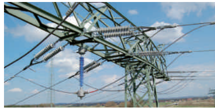
▲ Рис. 11. Система контроля температуры и натяжения в сборе
