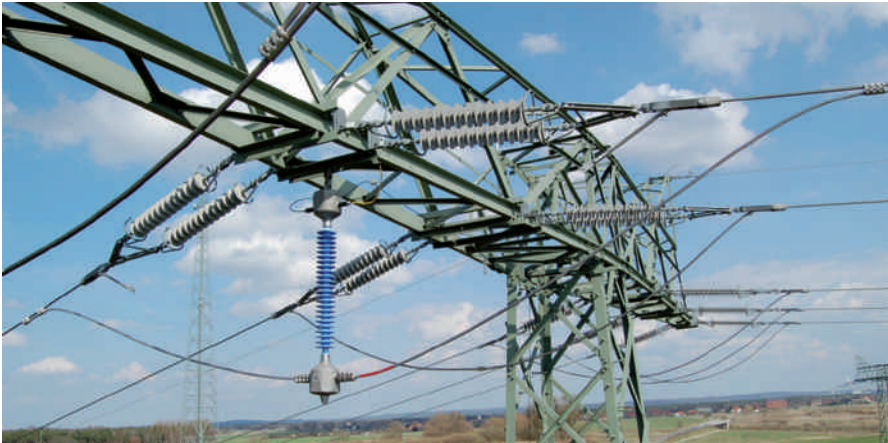
▲ Bild 11: Komplettes Überwachungssystem für Temperatur und Dehnung
