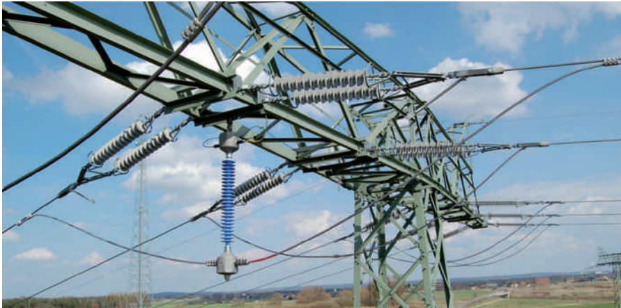
▲ Figure 11: Système de contrôle de la température et de la déformation complètement assemblé
