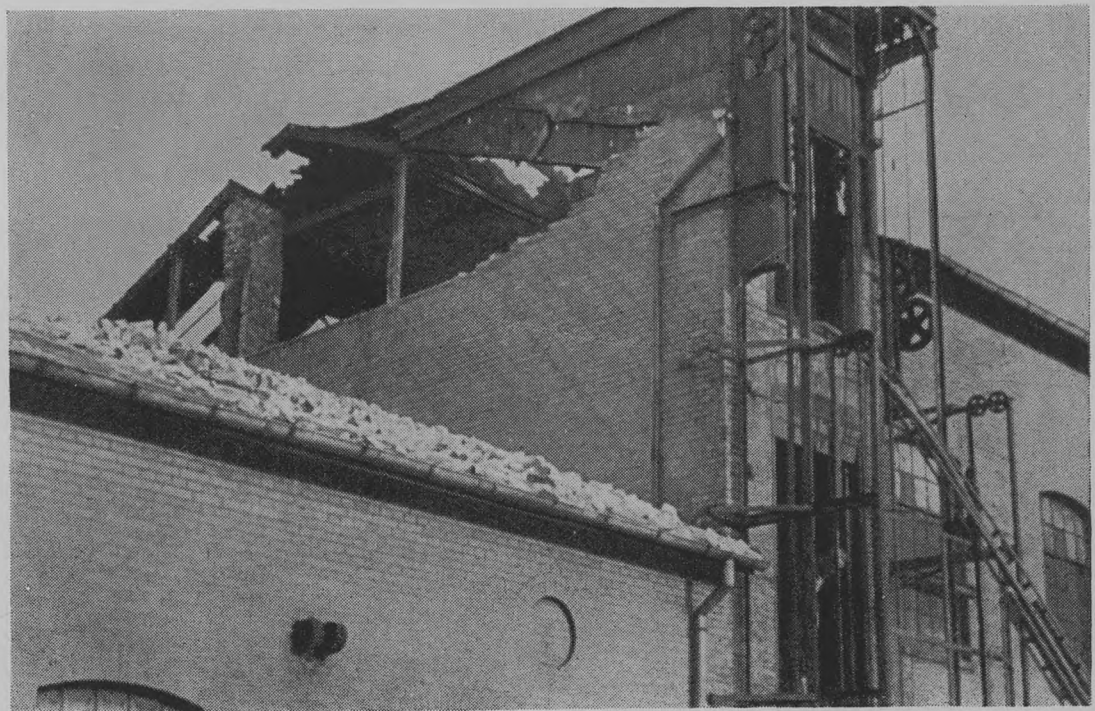
Billedet viser den nedstyrtede Gavl.
