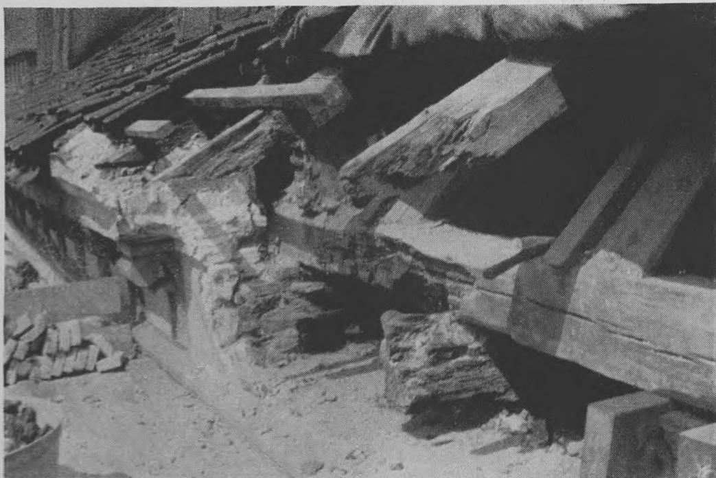
Billedet viser det ødelagte Tagværk, som delvis var bort- raadnet. Samtidig var Bygningens Hovedgesims, der havde en Udladning paa 45 cm, væsentligt forskubbet. Gesimsens Murværk gik ind over Fodremmen, medens Bjælkeenderne var ført frem til kun 10 cm fra Facadelinien.
