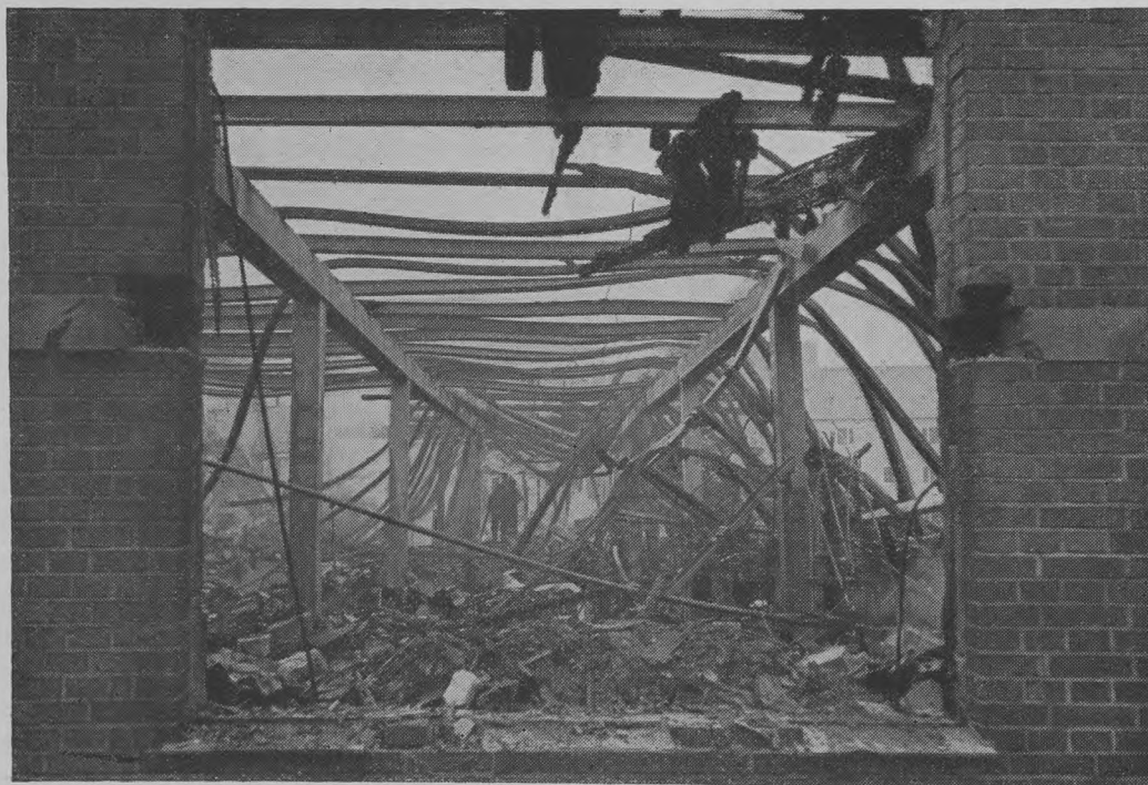
Billedet viser en Søjle- og Dragerkonstruktion udført af Jernbeton, der nærmest er upaavirket af Branden, medens selve Etageadskillelsen, der er udført af Jernbjælker, er ødelagt.
