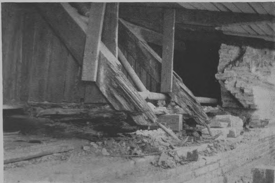
Eksemplet viser det ødelagte Træværk i Tagkonstruktion- en, efter at Hovedgesimsen var fjernet. Bjælkeenderne var fuldstændig raadne, og enkelte Bjælker var ødelagt fra 1,5 til 2 m fra Ydermuren.
