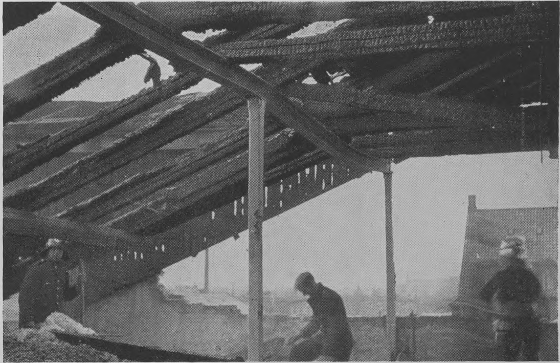
Billedet viser en uisoleret Jernaas, der som Følge af Ildebrand i Tagetagen har udvidet sig og har væltet Murværket i Gavlen.
