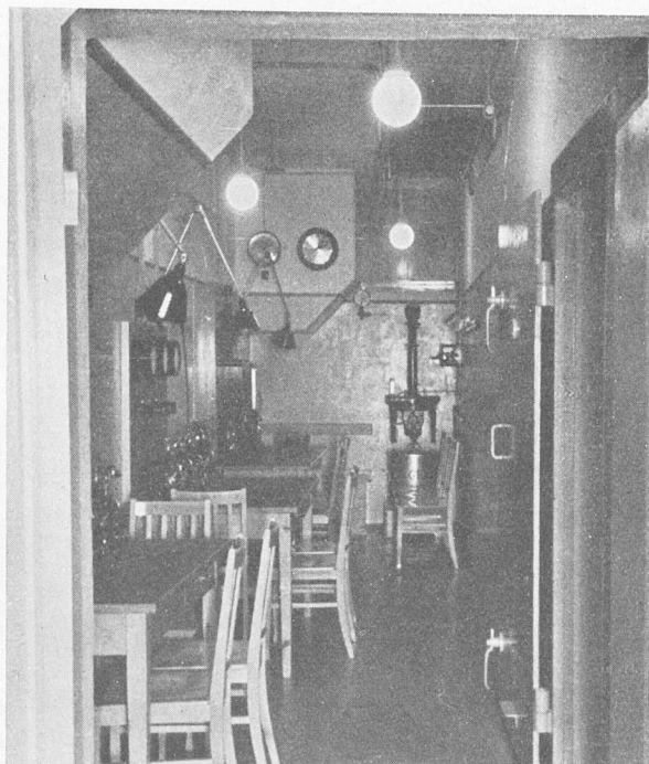
Beskyttelsesrum paa Gothersgade Elektricitetsværk, samtidig indrettet som Kommandorum for Omformerstationerne.
