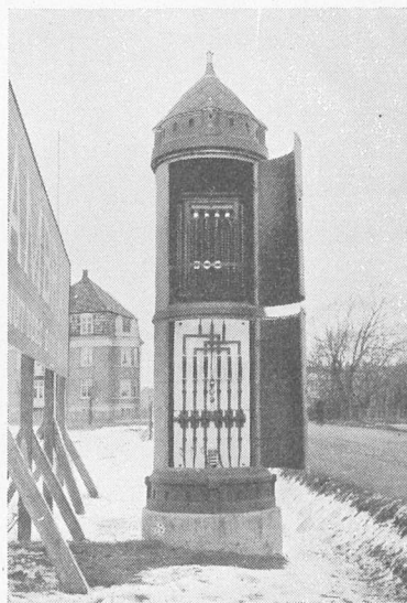
Transformortårn (Gimles Allé 1908). Foroven Transformatoren, fornedet Lavspændingstavlen.
