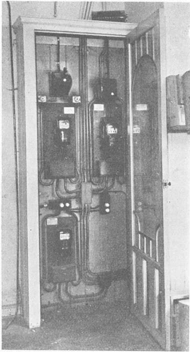
Maalerinstallation med Kviksølvmaalere og Ledninger i Bergmannsrør (Amagertorv 10, 1907).
