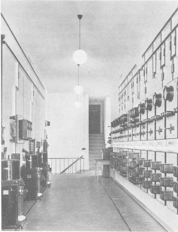
Valby Transformatorstation, Betjeningsgang. Til venstre 30 kV, til højre 6 kV.
