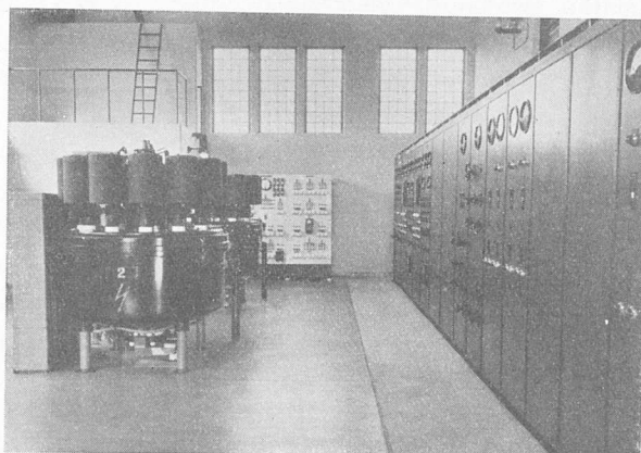
Bronshøj Understation. Maskinsal med Ensrettere.
