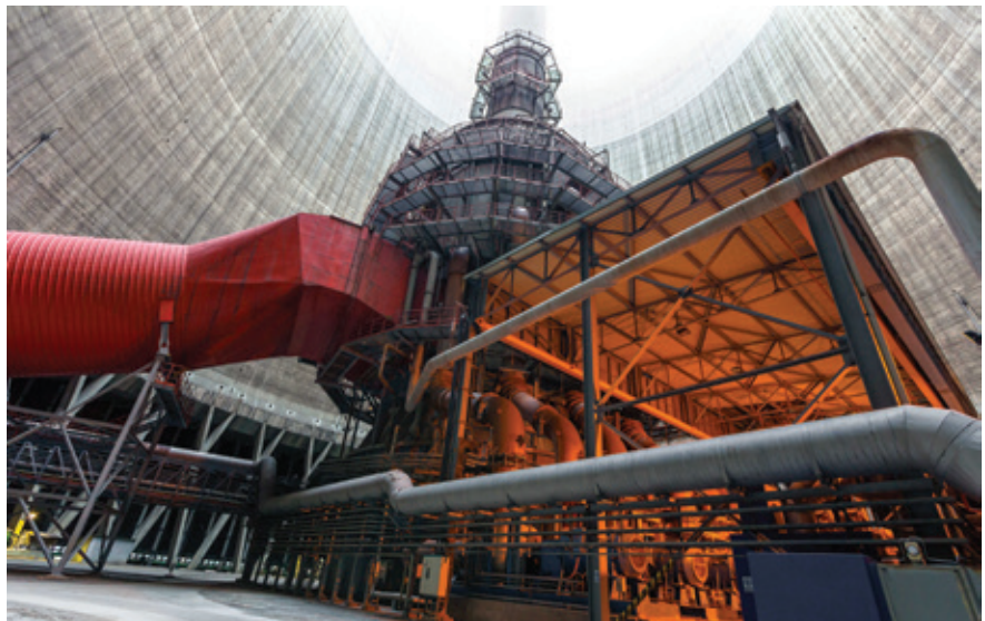
▲ Dampfleitungen, Überhitzerrohre sowie Abgassysteme in Hubkolbenmotoren und Gasturbinen sind klassische Anwendungsgebiete für den UGI 4550 von Ugitech. Aufnahme mit freundlicher Genehmigung von Ugitech – ©istockphoto_annavaczi
