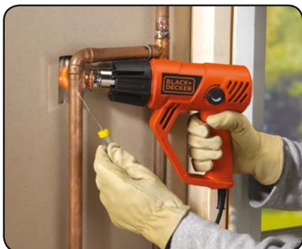
Dégeler les tuyaux.
