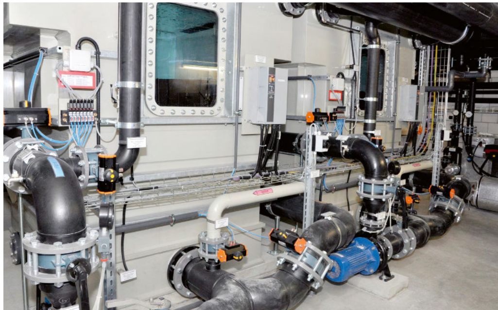
Viel aufwendige Haustechnik im Untergeschoss des 2016 erneuerten Hallenbads Uster: die Überlaufkammer mit Aktivkohlefiltern (rechts), die nachts durch Rückspülung gereinigt werden.
