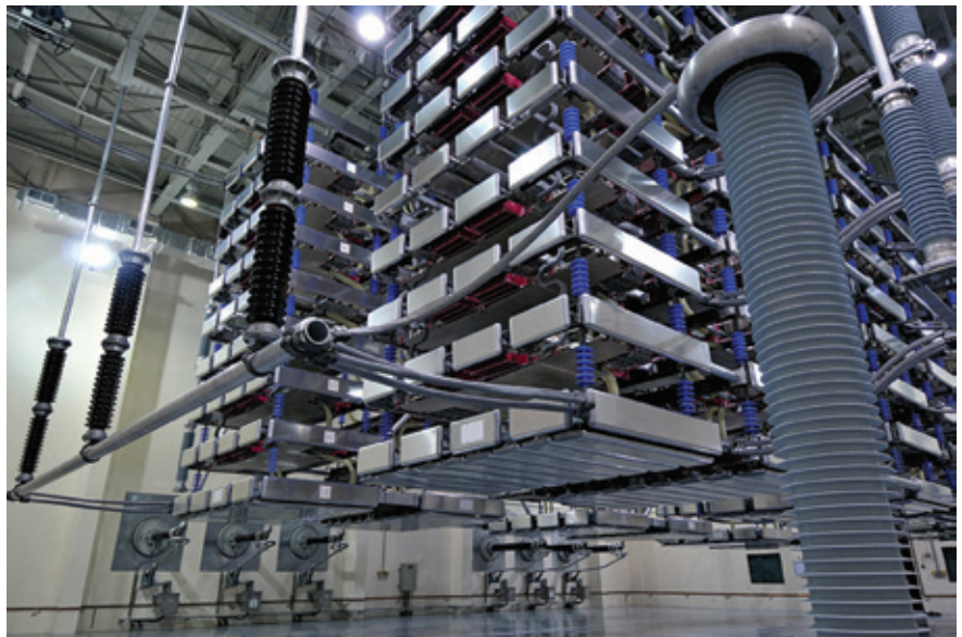
○ Alstom 高压直流阀厅
