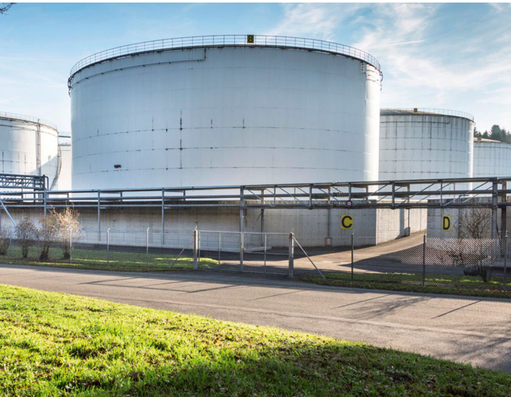
Im Norden der Gemeinde steht das grösste Tanklager (Öl und Benzin) der Schweiz.
