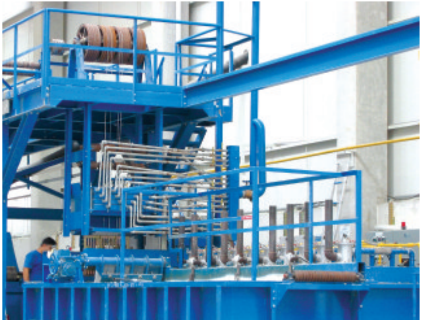
○ QED 镀锌线使用双环压力控制系统
