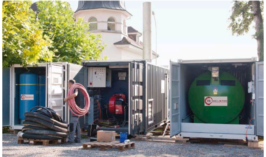
Mobiler Heizcontainer und entsprechendes Zubehör (von links: Expansionsanlage, flexible 4-Zoll-Schlauchverbindungen, betriebsbereite 2,5-Megawatt-Heizzentrale, 13 000-Liter-Heizöltank). Bild: Mobil in Time®
