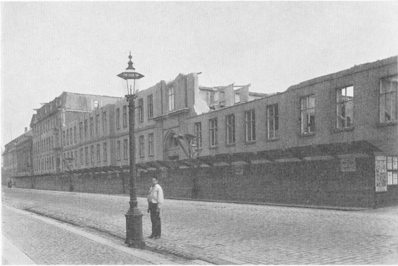
Nedbrydningen af Almindelig Hospital er i gang. Yderst til venstre i billedet skimtes den Classenske biblioteksbygning. Fotografi fra sept. 1895.
