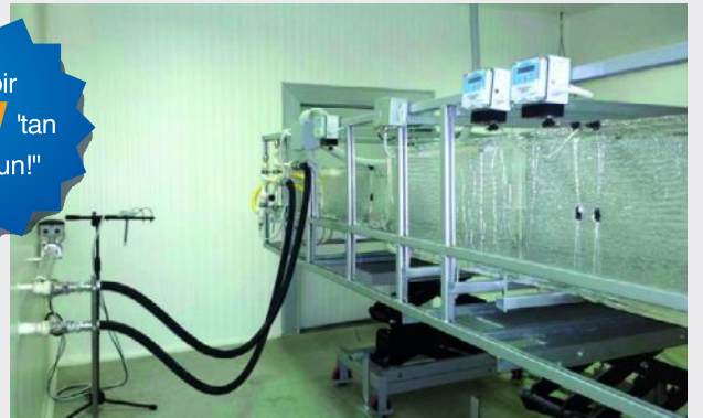
► Fan Coil Performans Test Laboratuvarı ve Araştırma Merkezi
