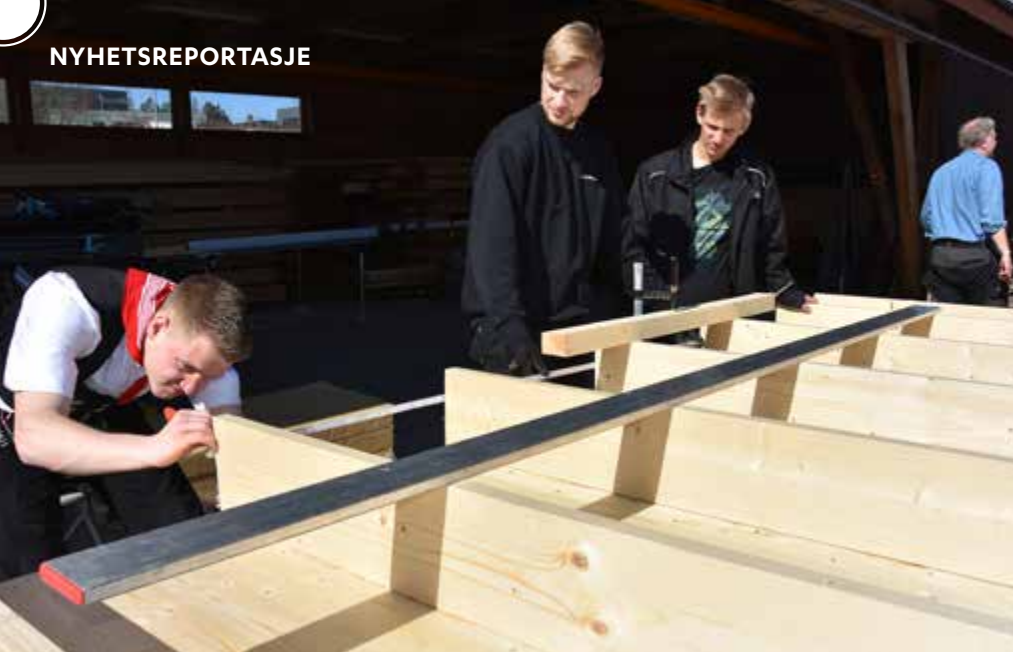
Tyske Daniel Schäbs og Lukas Reineke og norske Steinar Langeland i samarbeid om bygging av passivhus.
