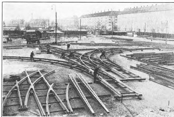
Fig. 68. Skinnepladsen i Borups Allé
