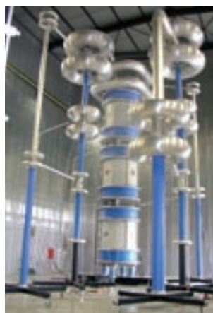
○ Highvolt AC共振试验系统; 图片由Demirer Kablo AS提供
