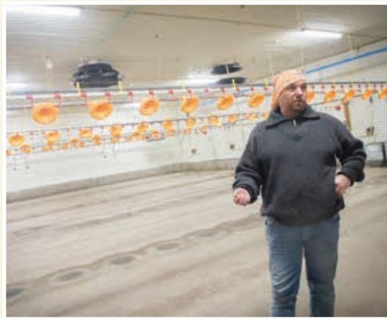
SNART TJENT INN: Kyllingbonde Dag Vidar Barstad har hatt varmeveksler i kyllingfjøssett sitt i ett år. Han ser store fordeler både på lavere oppvarmingskostnader, bedre innemiljø og mindre utslipp av CO 2 .
