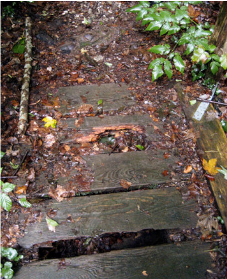
Durch fehlenden Unterhalt werden Holzbauteile morsch und zum Sicherheitsrisiko.
