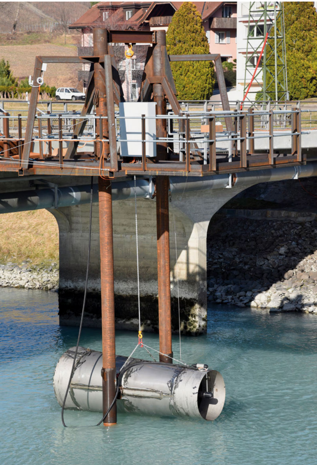
Le premier prototype d'une hydrolienne fluviale est installé dans le canal de fuite de la centrale hydroélectrique de Lavey (VD) pour une durée de six mois.
