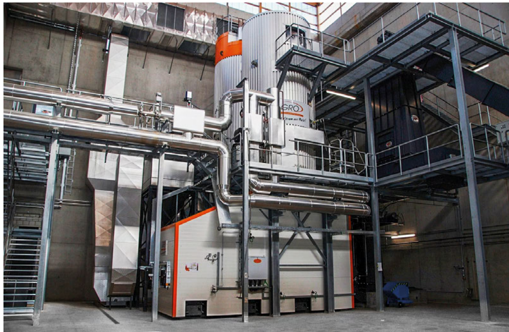
Im Holzkessel des Wärmeverbunds wird einheimisches Holz verfeuert.
