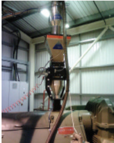
○ 安装在Prysmian工厂的Maguire的重量损失(LIW)料斗
