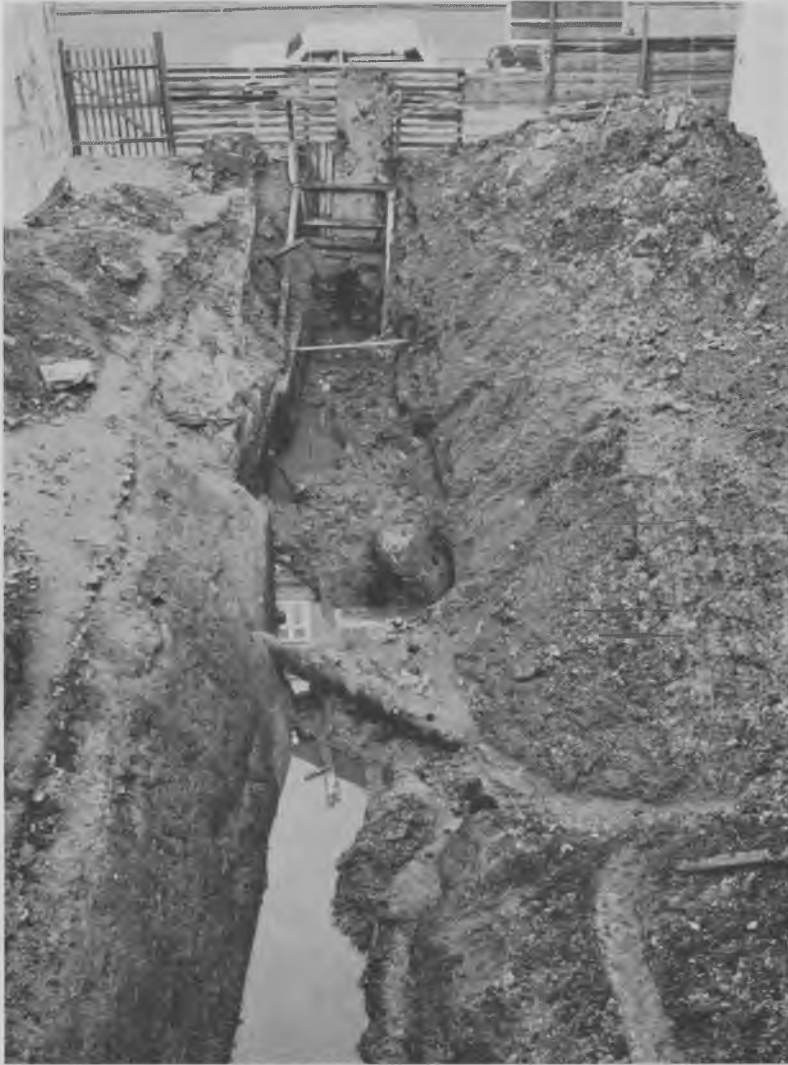
Fig. 1. Den vandfyldte udgravning fra syd. I mellemgrunden en trævandledning. Bagved ses den store sten ved bolværket. Nordligst skimtes, under afstivningen, tømmer fra mølledæmningen. I baggrunden Løngangsstræde
