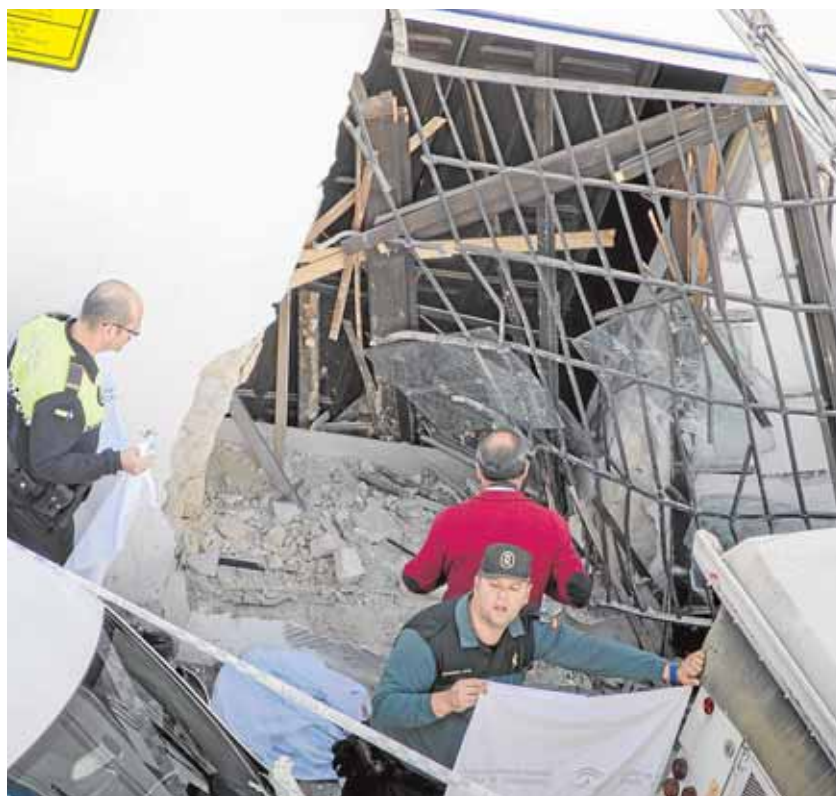
El fuerte choche arrancó una de las ventanas del edificio de Hacienda ABC
