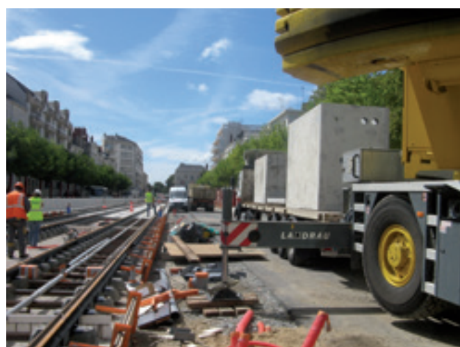
Chambres de pompage Tramway Angers (49)
