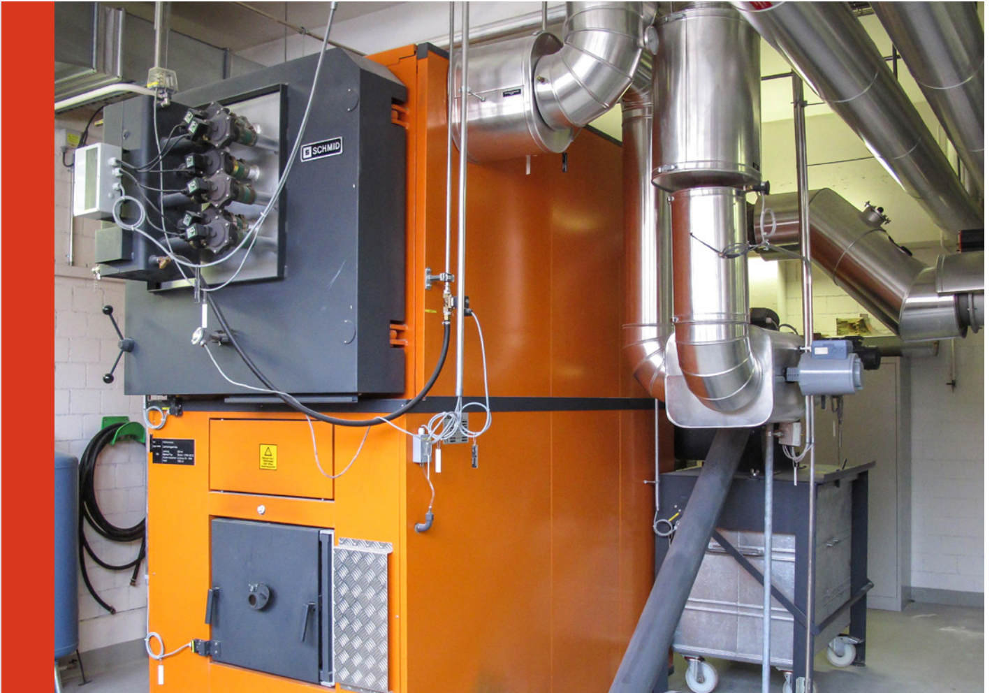
Bild einer Wärmezentrale
