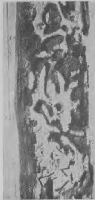
Fig. 25. Bagsiden af dørindfatning med gange af barkbiller.
