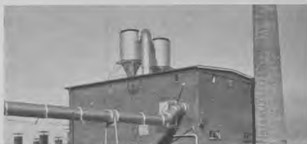
Fig. 329. Cyklonen til et større spånsugningsanlæg anbragt på taget af kedelhus. Hovedrøret har en diameter på 720 mm og en lufthastighed på ca. 21 m/sek. Til mindre spånsugningsanlæg vil det ofte være formålstjenligt at anvende posefilter i stedet for cyklonen.
