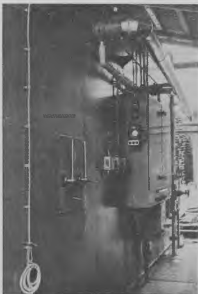
Fig. 85 b. Manøvrecentral for højtemperatortørreanlæg. (Svenska Fläktfabriken).
