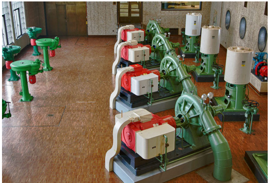
Trinkwasserpumpen sind der grösste Stromverbraucher im Gemeindebudget. Der Pumpencheck von InfraWatt zeigt Sparpotenziale auf.
