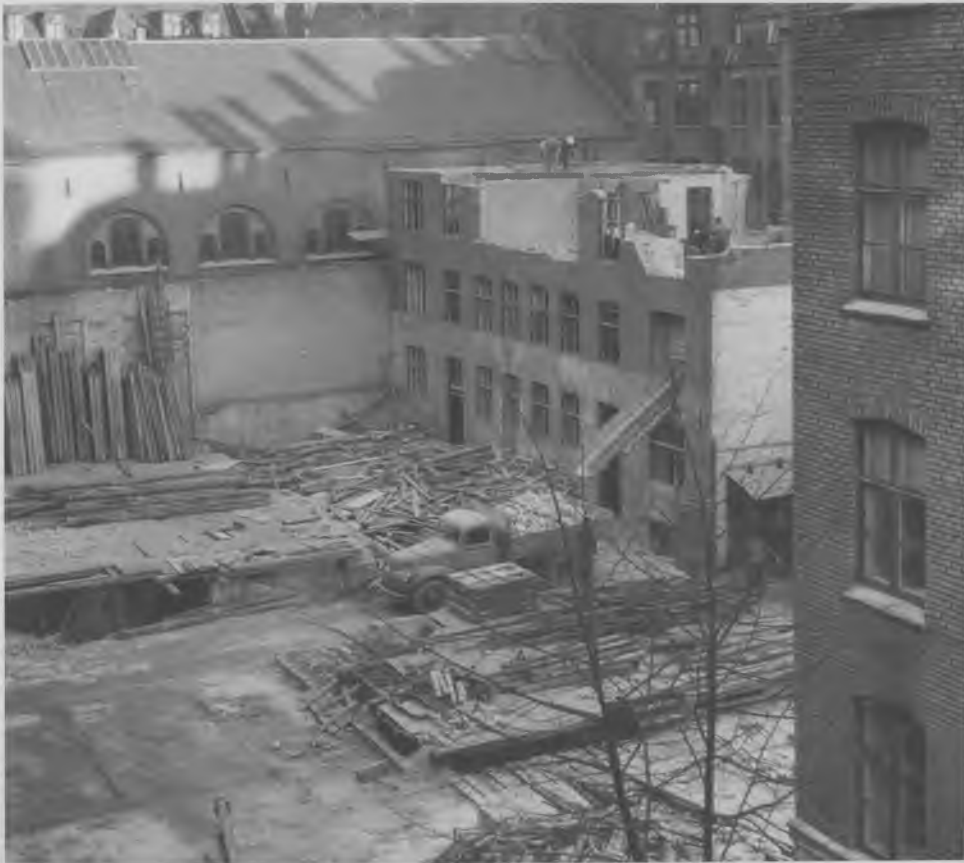
Nedrivningen af baghuset er i fuld gang, mens mellembuset allerede er jævnet med jorden. Det er Apostelkirken, der ses i baggrunden. Billedet er fra 1958.
