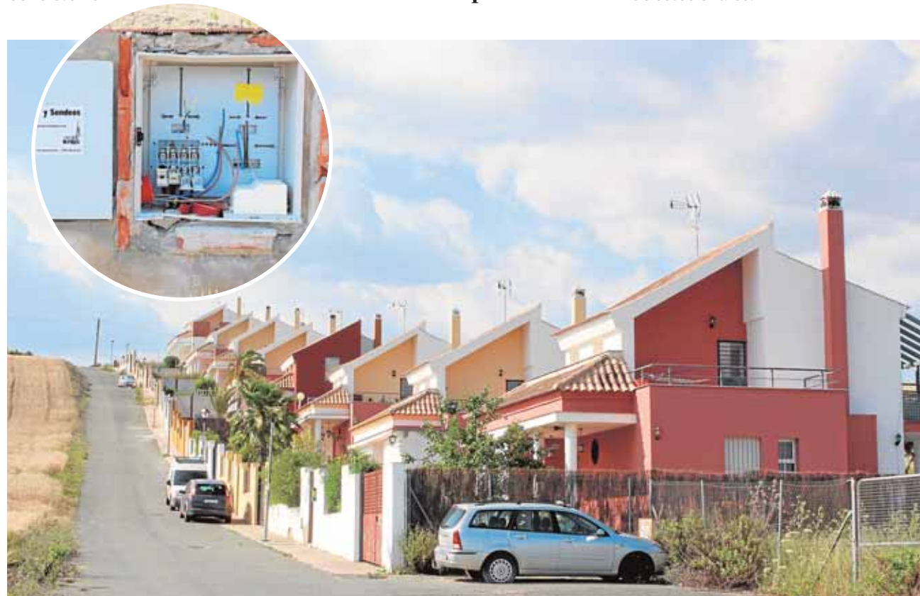
Urbanización «Los girasoles». En detalle, el deteriorado contador del alumbrado público
