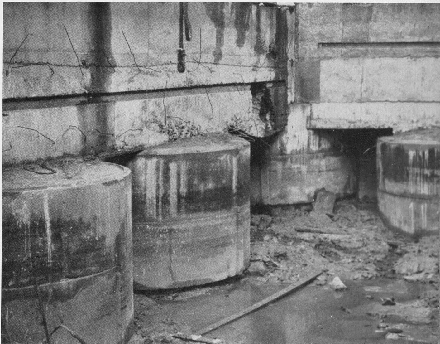
Betoncylindre i tørlagt byggegrube 12 m under havets overflade. Ved udstøbning over undervandsbetonen koncentrerede man sig i første omgang om den sydlige del af byggegruben, hvor vandet var brudt ind, og om længdevæggene for her at skabe en større belastning og dermed større sikkerhed mod opskydning af det underliggende lag, når vandstanden senere skulle sænkes til en dybde af 12,8 m, og bassinet i midten skulle udgraves og udstøbes. Der var som nævnt i teksten hovedsagelig støbt med undervandsbeton langs spunsvæggene og iøvrigt kun anbragt enkelte cylindre i midten af byggegruben. Billedet viser de kæmpestore cylindre i 12-13 meters dybde.
