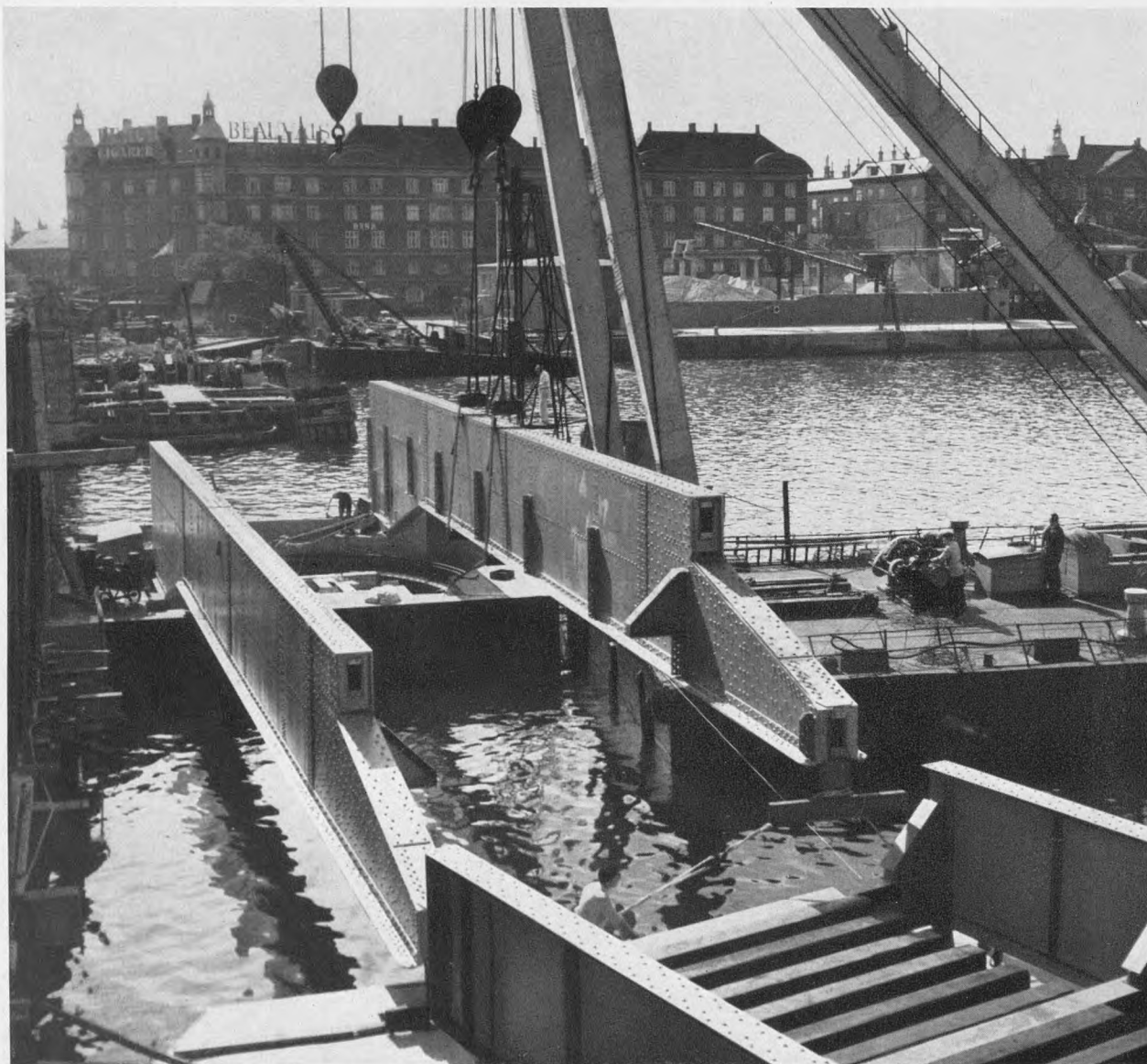
Hoveddrager fra jernbanebroens svingfag sættes på plads. Fotografi fra september 1952. Mens broens faste fag lod sig flytte i færdigmonteret stand, måtte man tage een af svingfagets hoveddragere ad gangen og ved hjælp af havnevæsenets flydekran anbringe dem på svingpillerne, hvorefter de enkelte bjælker i brobanen blev lagt på plads og det hele nittet sammen. Svingfaget måtte naturligvis monteres i åben stilling af hensyn til sejladsen.
