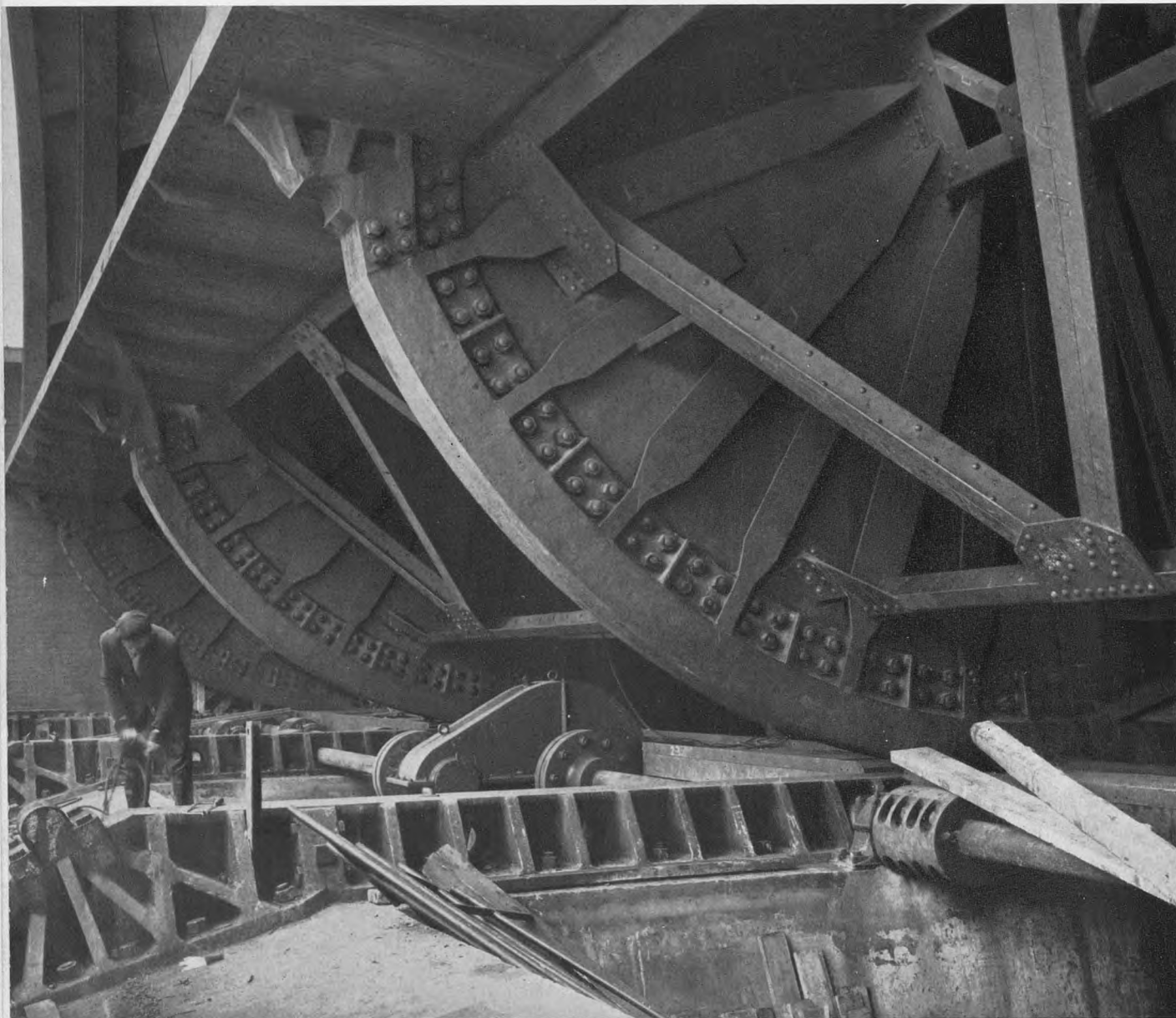
Rullegænger og rullebaner i østre klappille. Fotografi fra marts 1954. Hvert rullegænge er udført i eet stykke, der vejer 6 tons. Klaphalerne i hver af de fire hoveddragere er indbyrdes forbundet med tværafstivninger, der dels sikrer dragernes indbyrdes stilling under broens bevægelse, dels overfører tandstangstrækket, der kun virker på de ydre hoveddragere.
