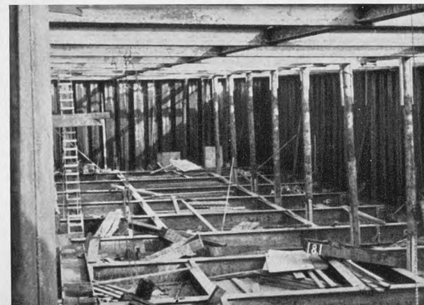
Midt i byggegruben. Man ser den øverste lettere og den nederste sværere afstivning. Fotografi fra maj 1951.
