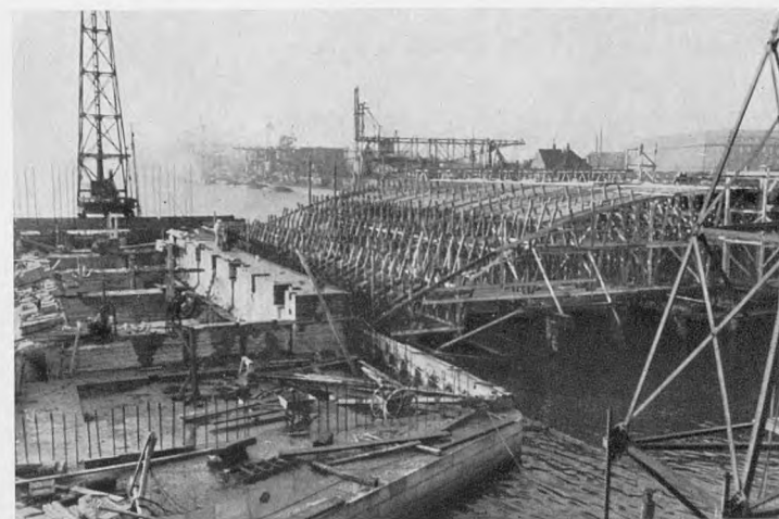
Sjællandssidens klappille og buefag i februar 1952. Mens pillen er støbt så højt op, at fangedæmningen er fjernet, er det endnu kun tømmerkonstruktionen, som viser betonbuens underkant.
