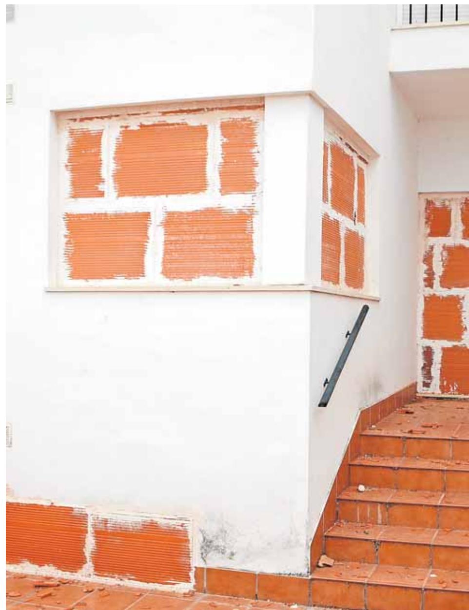
Los propios vecinos de los Ruedos están tapiando con cemento y ladrillos las ventan...
