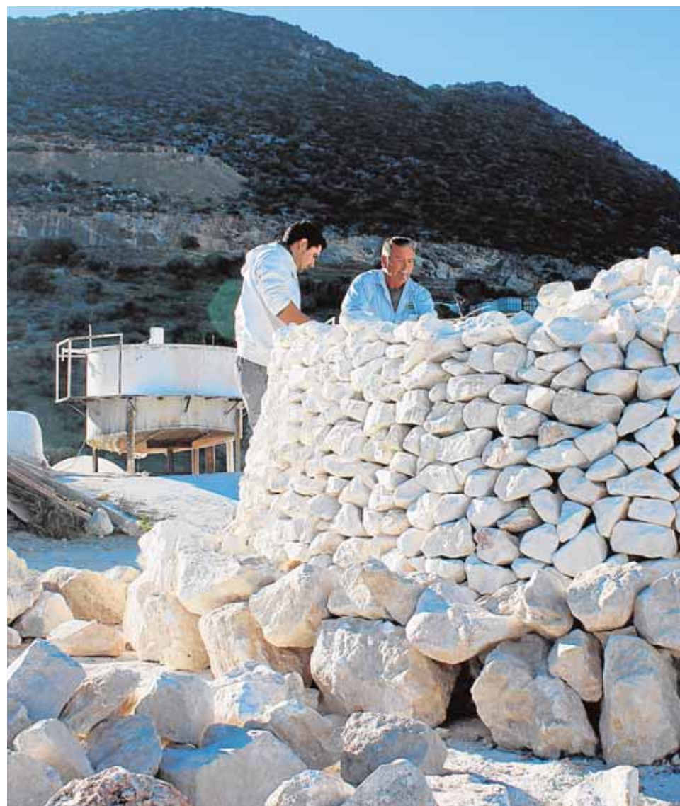
Uno de los hornos en las últimas fases de construcción por dos de los caleros, maestros.
