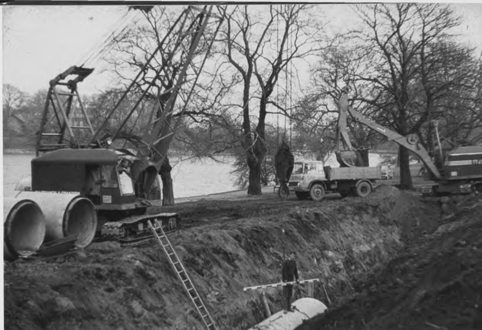
Den nye udløbsledning fra Renseanlæg Damhusåen er her under udførelse ved Stadsgraven. Omkring 1970.
