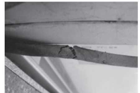
▲ Рисунок 1. Повреждения провода, вызванное озоном и высокими температурами
