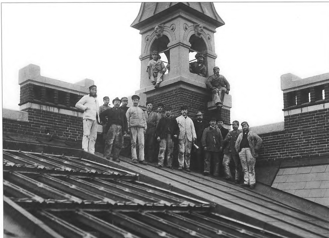
Skifer- og kobberdækkere samlet om et af de små hjørnetårne i højde med tindemure og udluftningskanaler.
